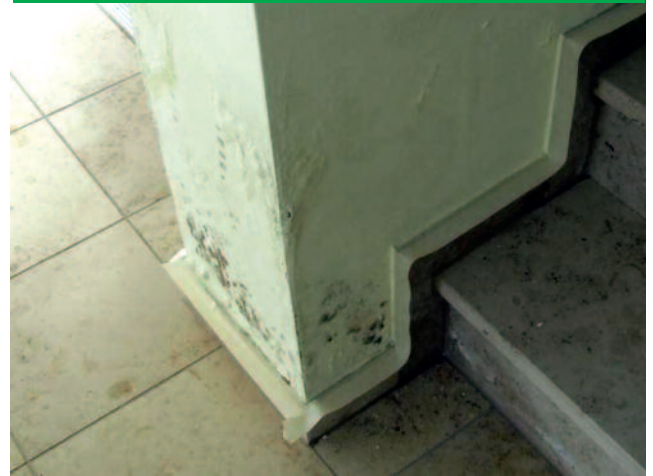
Abb. 1: Beispielhaft eine Schadenstelle im EG
